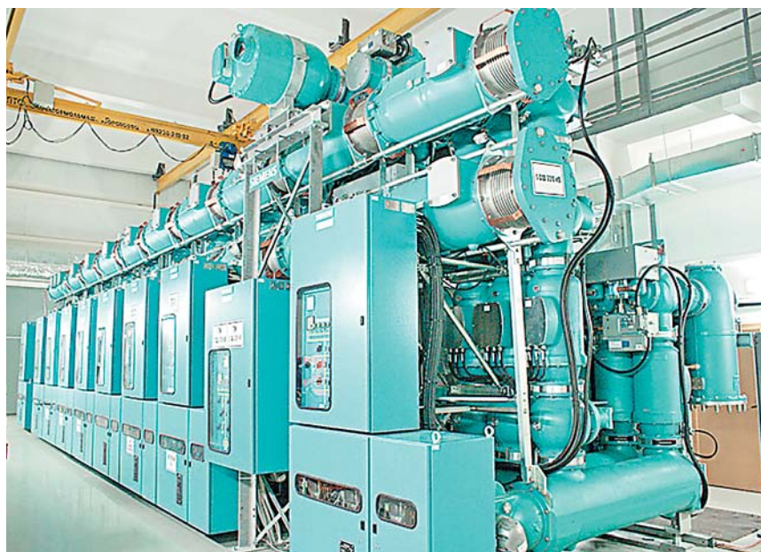
РАСПРЕДЕЛИТЕЛЬНОЕ УСТРОЙСТВО ЗАКРЫТОГО ТИПА.
